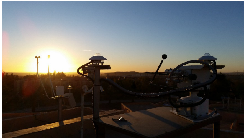
Figure III.1 : Station radiométrique de l'URAER (Ghardaïa).
