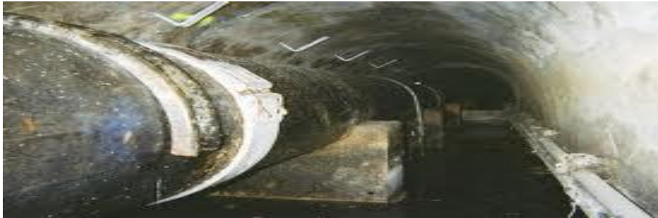
FIGURE 12 : CONDUITE EN FONTE
