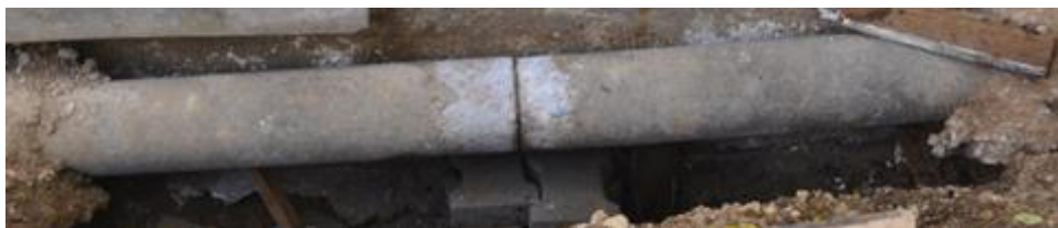
FIGURE 11: CONDUITE EN AMIANTE CIMENT
