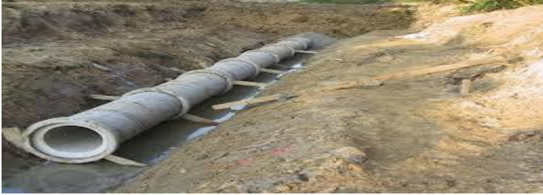
FIGURE (15) : CONDUITE EN BETON ARME
