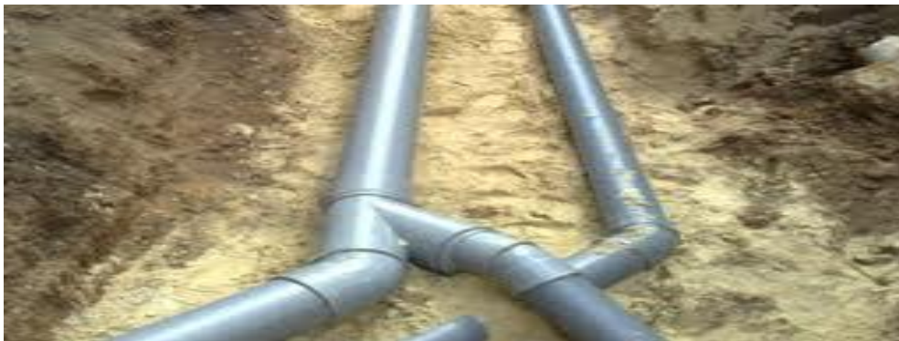
FIGURE (14) : CONDUITE EN PVC
