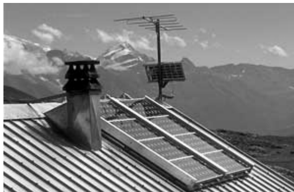
Figure 1.3 L'utilisation des panneaux photovoltaïques
